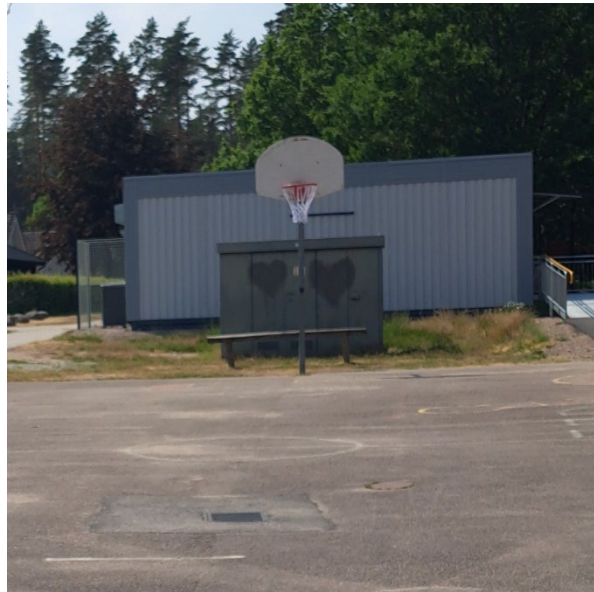
Transformatorstationen, vy från öst.
